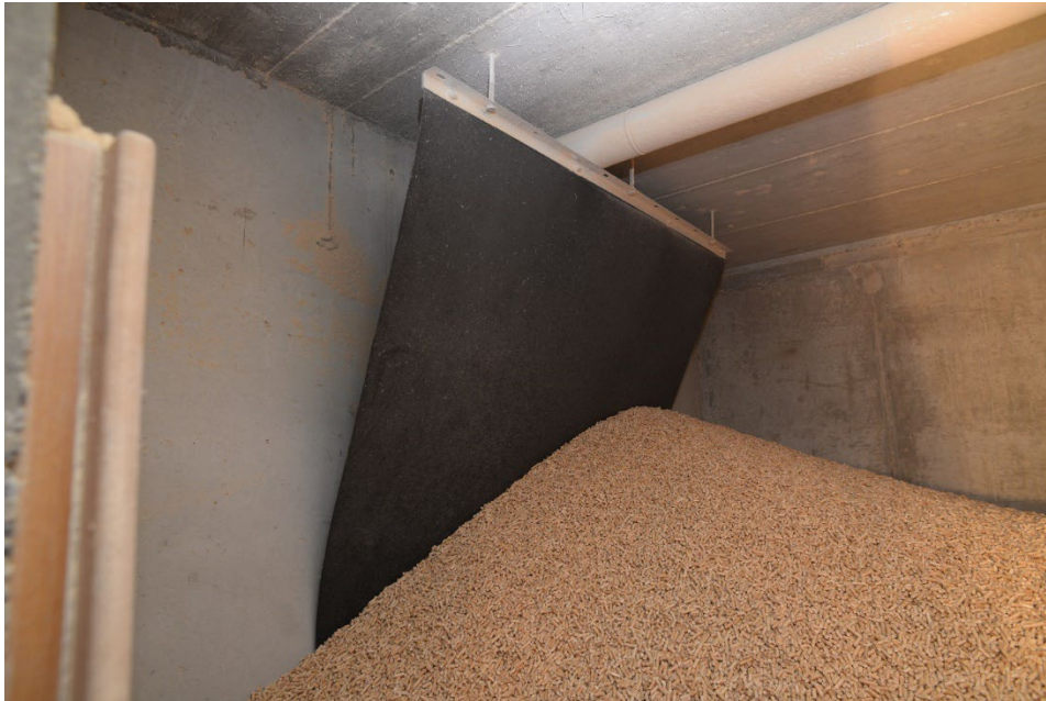
Entrepôt de granulés avec tapis d'impact.
